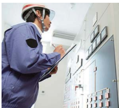
変電所配電盤定期検査
